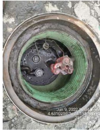
Foto 13. Bomba sumergible del tanque de ACPM-
