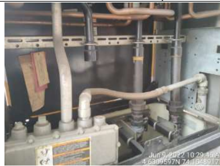
Foto 11. Sistema interno dispensador cuatro
