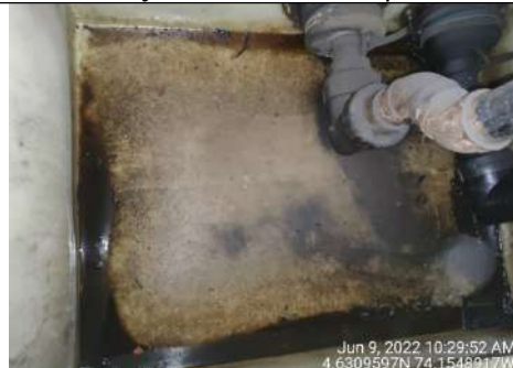
Foto 10. Caja contenedora dispensador cuatro
