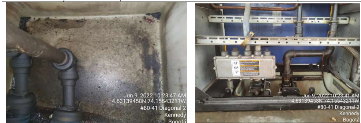
Foto 6. Caja contenedora dispensador dos
