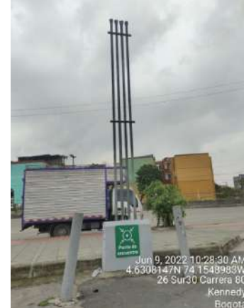
Foto 12. Foto de los tubos de desfogues
