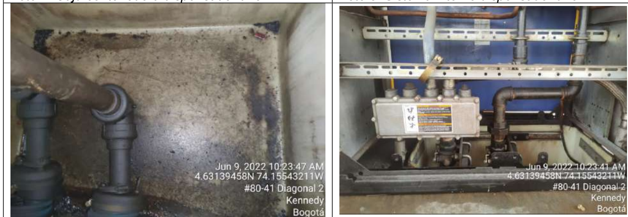
Foto 6. Caja contenedora dispensador dos
