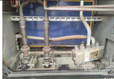
Foto 9. Sistema interno dispensador tres
